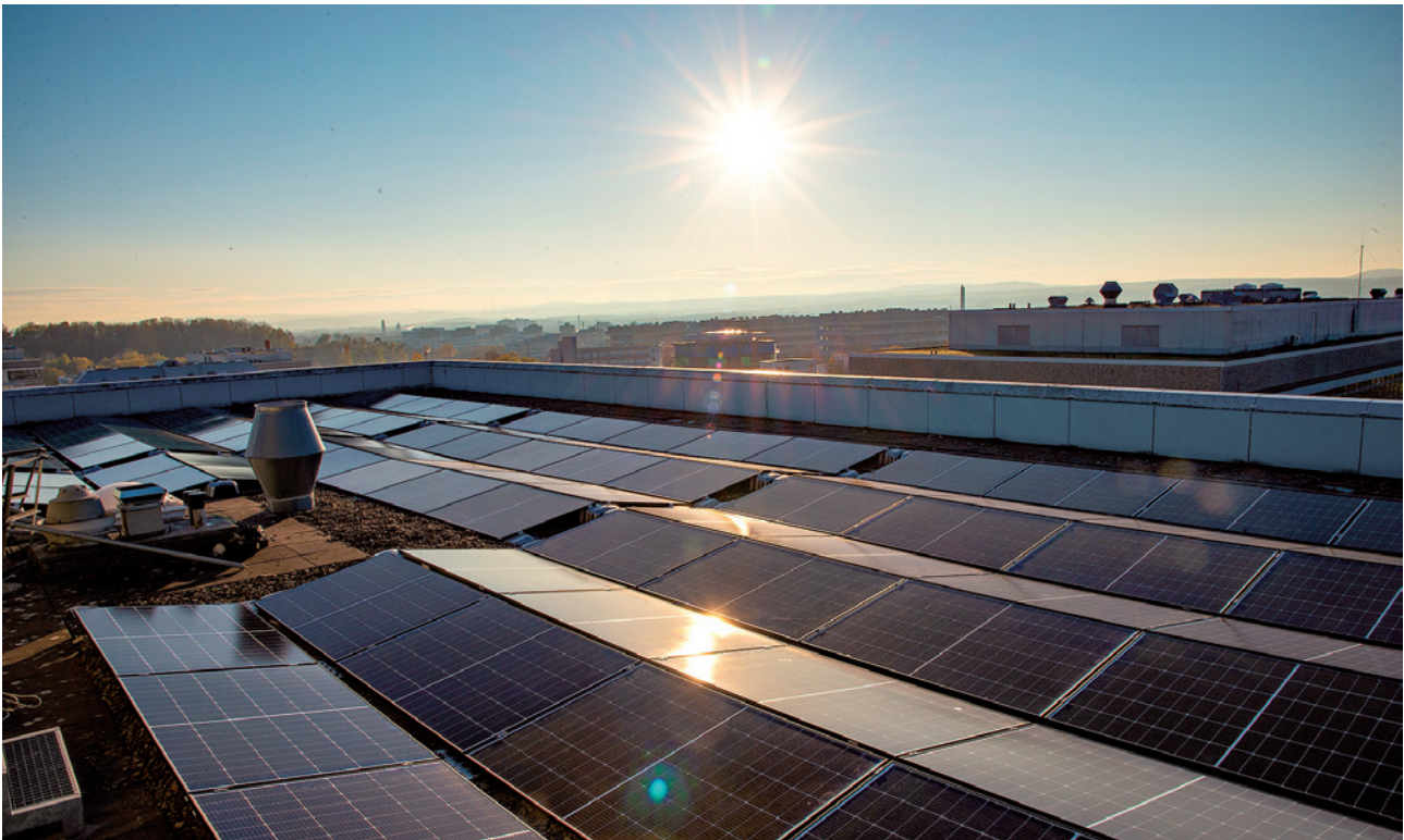
Solarmodule auf dem Dach des Bürogebäudes am DPZ. Foto: Karin Tilch
